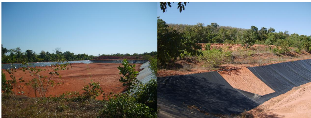
Figura 2 Obra inacabada do aterro sanitário de Cáceres-MT onde pode ser observada a manta de impermeabilização destruída.
